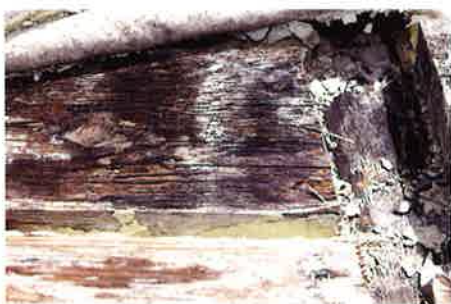
Abb. 4: verfärbte, mazerierte Holzoberfläche
