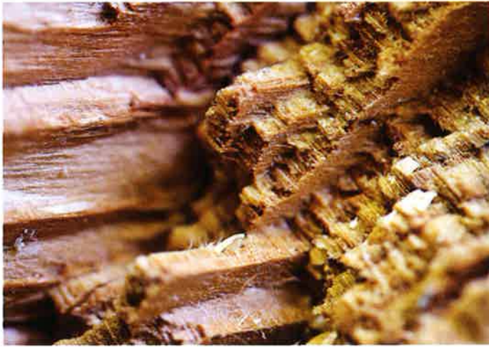
Abb. 8: Bruchstelle eines Balkens mit kurzfaserigem Bruchbild
