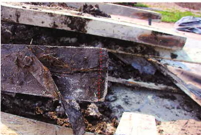
Abb. 11: ausgebauter Sparren, der schon vor dem Rückbau im Substrat lag und an dem auf Grund der Abdrücke eine Auflagetiefe von 2 cm festgestellt wurde
