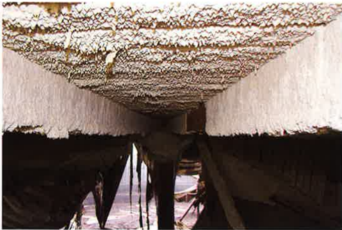
Abb. 4: Schwefelablagerungen auf der Unterseite einer Holzdecke
